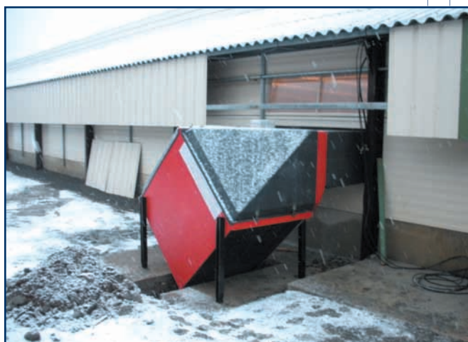
Los recuperadores de calor generan un ahorro energético interesante a tener en cuenta
